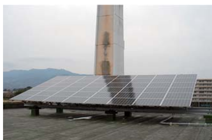
太陽光発電設備 (医学部附属病院中央機械室屋上)
